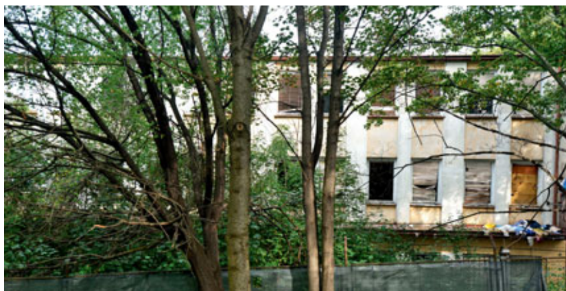
Západní strana zdevastovaného objektu.
